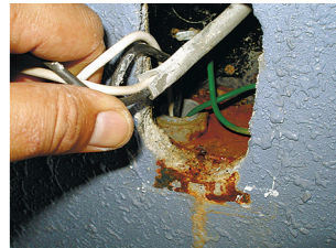
写真3・コンセントボックス内部に生じたさび
