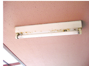
写真1・防雨防滴ではない照明器具
