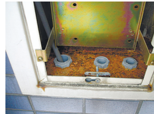
写真2・警報盤内部に生じたさび。この事例では階下設備にも漏水した
